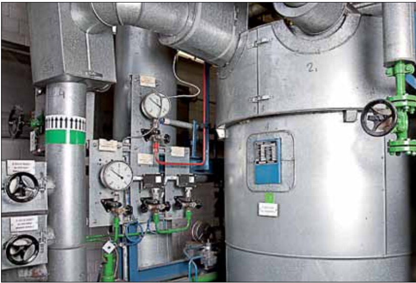
Bild 3. Die einzelnen Aggregate der Anlage sind im Anlagenverzeichnis erfasst
